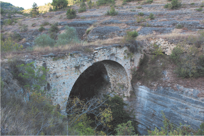
Fotoğraf 192. Tarihi bir değeri olan Malagöz Köprüsü'nde yapılan kaçak kazılar sonucu; köprü'nün iki yakası, ayakları ve orta kısmı tahrip edilmiş.
